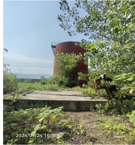
厂内污水处理站（现有）
