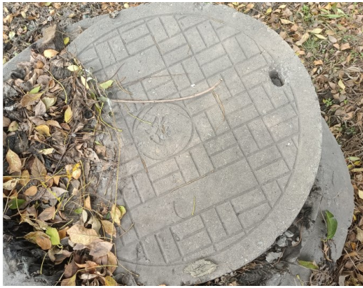
项目东侧开源路污水管网
