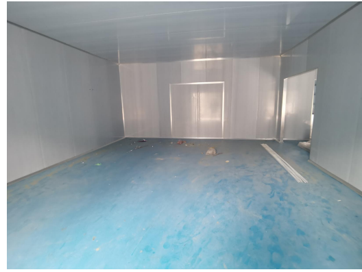
生产车间内部
