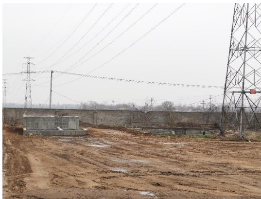
自建污水处理站
