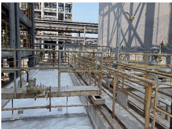
废水中和、混凝沉淀池
