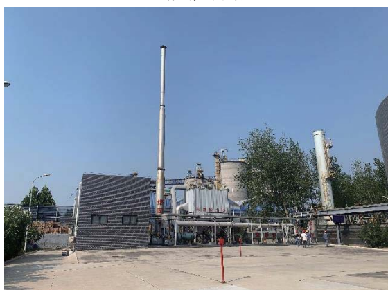
现有工程焚烧炉及一期事故火炬
